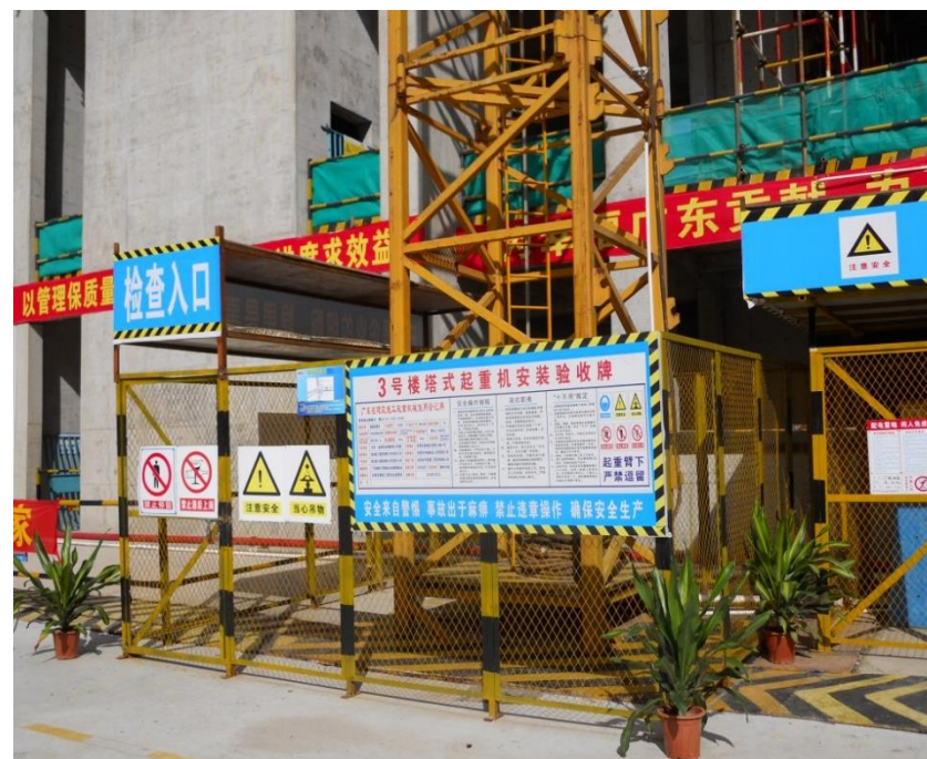
塔吊底部防护栏杆
