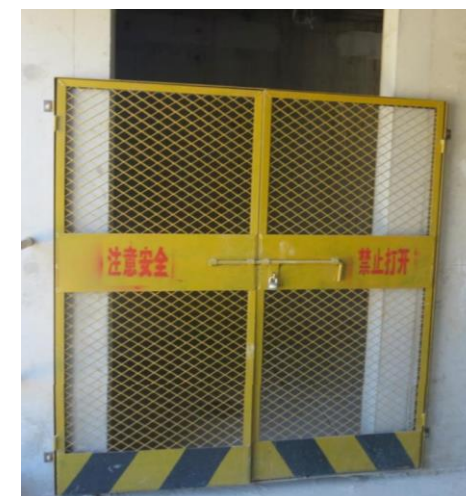
电梯井洞口防护门(三)
