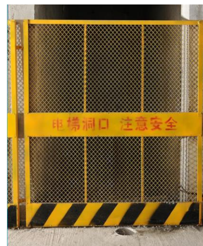
电梯井洞口防护门(二)
