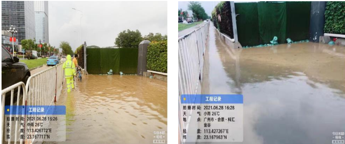
图 4 2021.6.28 工地围蔽外道路积水情况
