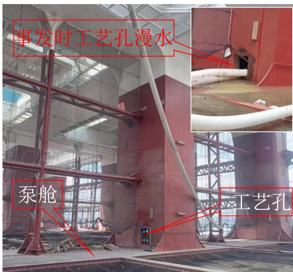
图3 “普盛海洋牧场 6 号”主甲板及泵舱情况
